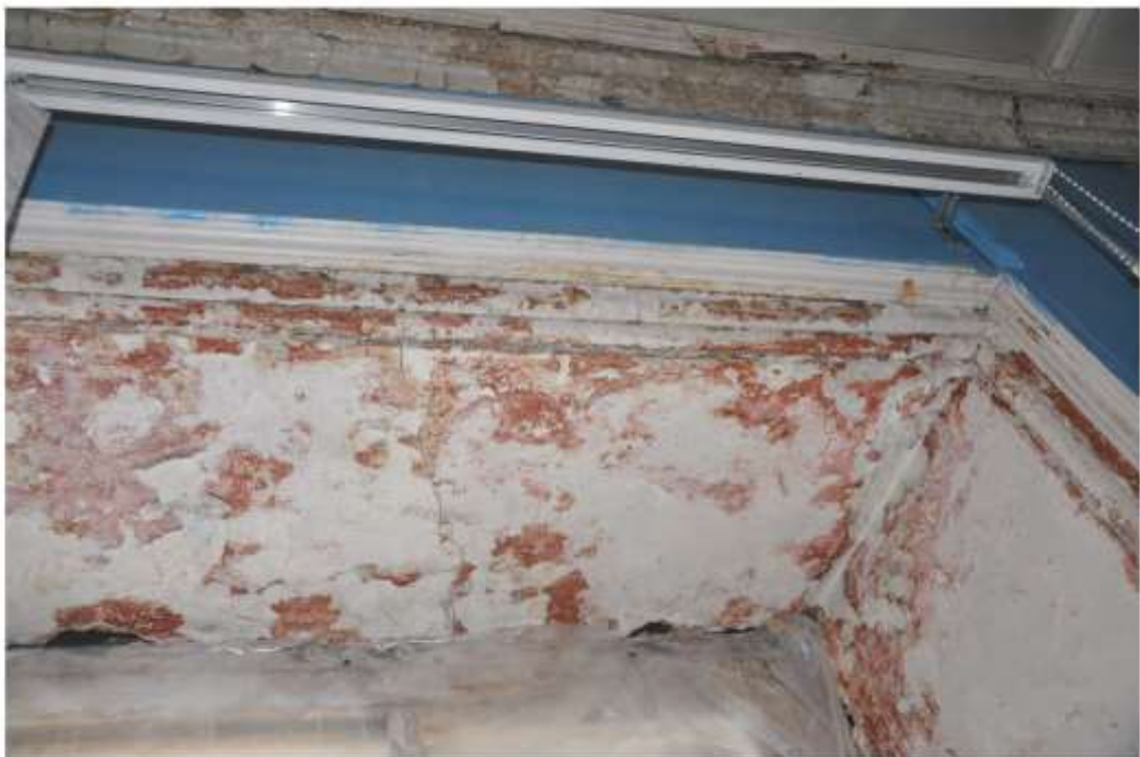
32. Повреждение протечками и грибок откосов среднего окна.
