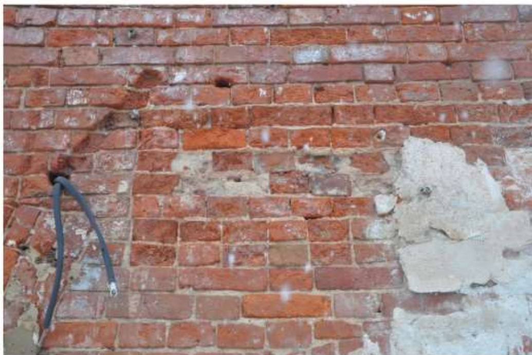
12. Остатки сбитого декора на западном фасаде, северная часть здания.
