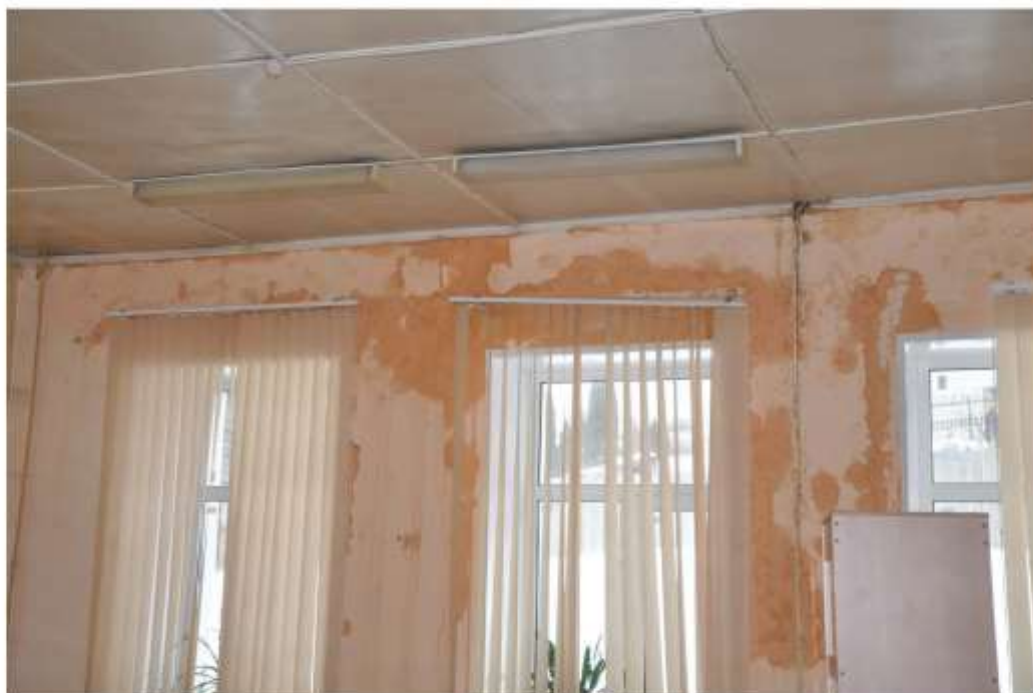
19. Следы протечек. Южная часть, восточная стена.
