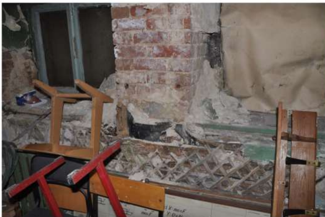
44. Биопоражения и высолы на восточной стене цокольного этажа.
