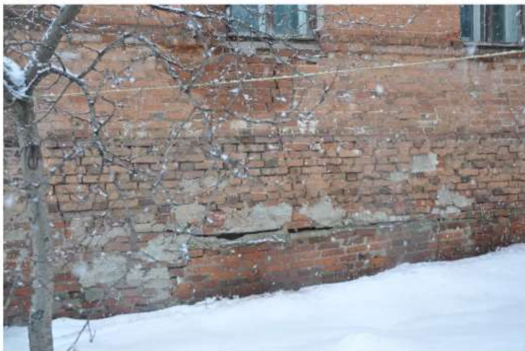
11. Вывал кирпичной кладки на западном фасаде южной части здания
