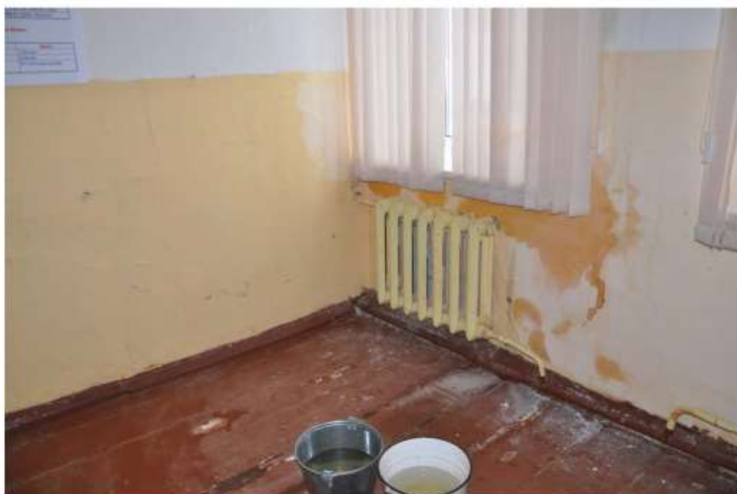
20. Следы протечек. Восточная стена.
