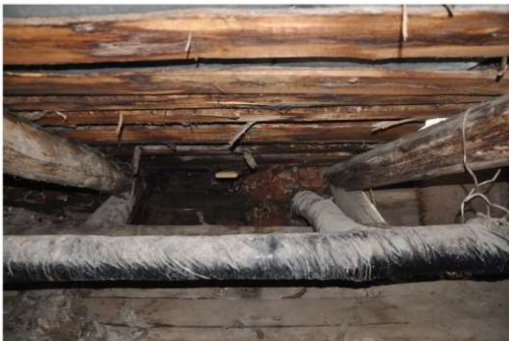
50. Разрушение конструкций гнилью на участка протечки кровли.
